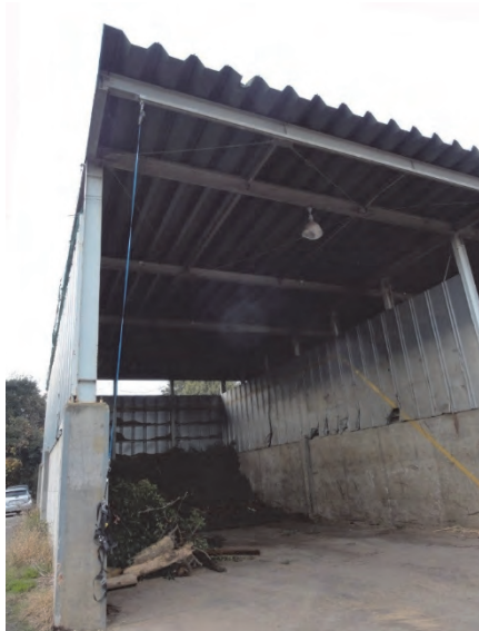
(写真1) 墜落制止用器具取付設備
